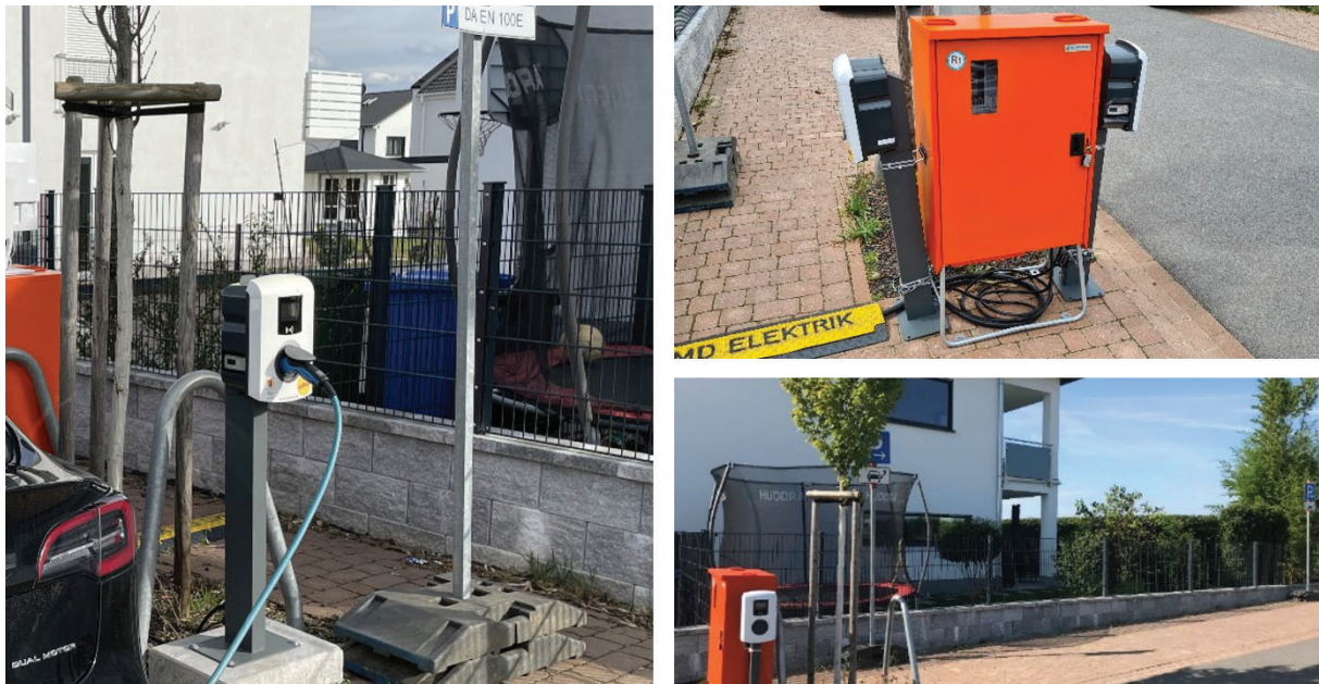
Abbildung II-16: Zwei Ladestationen (Wallboxen) und Baustromzähler im Georg-Eidmann-Weg
