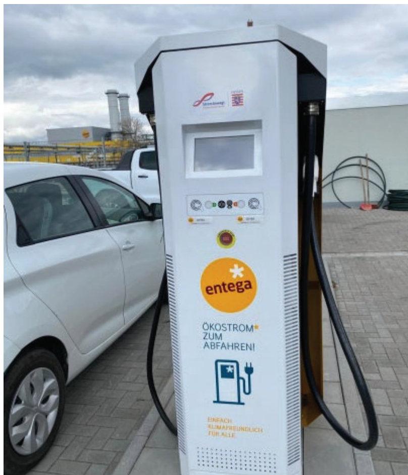
Abbildung II-36: Schnelllader am Ladepark (Eigene Darstellung: e-netz Süd Hessen AG)
