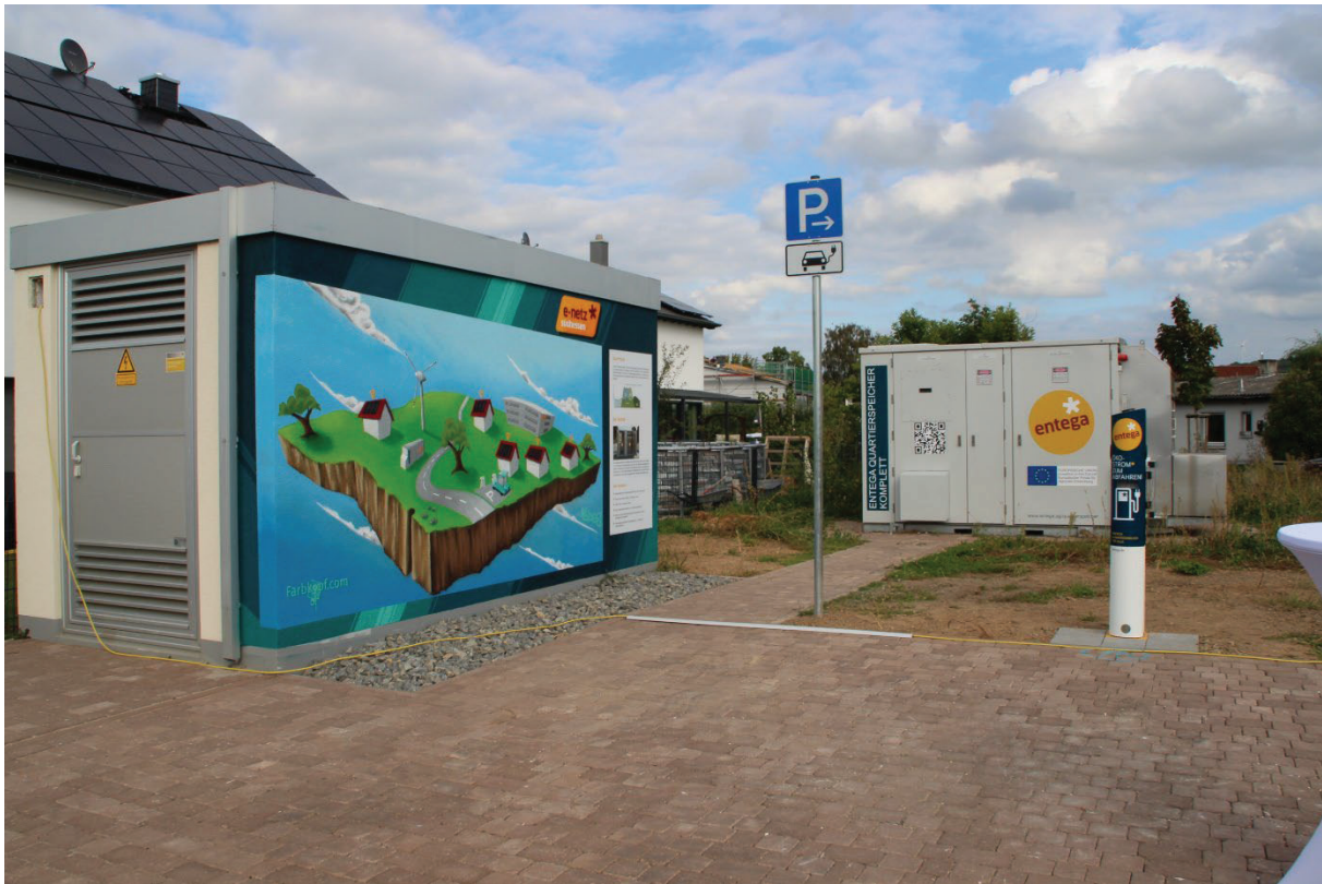
Abbildung II-19: Ladestation Wilhelm-Voltz-Weg (Links die Trafostation, im Hintergrund der Quartierspeicher)
